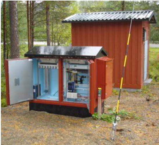
Bild: Exempel på föreningsnod i form av utomhusskåp framför teknikbod (Telia telestation i bakgrunden)
